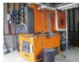
▲木質バイオマスボイラー
