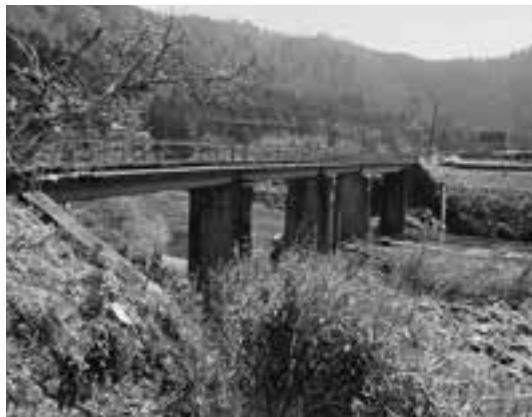
▲修繕予定の下吉田大橋(美山)
