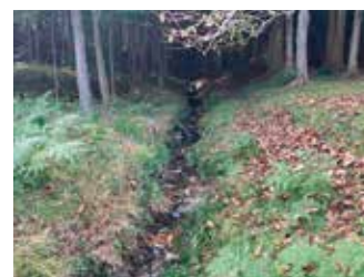
早期の改善が望まれる素掘り水路
