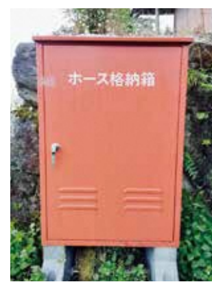
消防ホース格納箱
