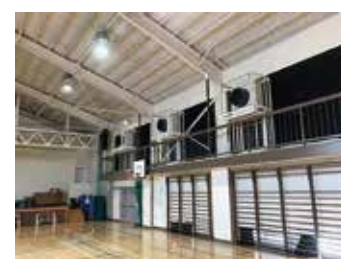
避難所となる学校体育館に空調設備を
