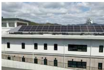
庁舎に設置されている太陽光パネル
