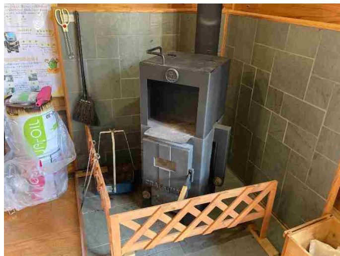
図 5-49 公共施設におけるストーブの設置例（府民の森 ひよし）
