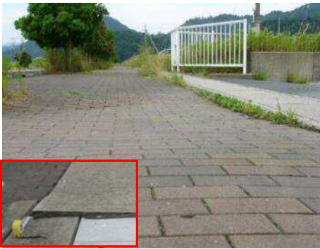
□歩道舗装が沈んでいる
