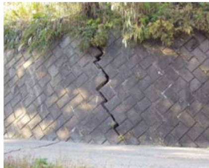
□構造物が壊れている
