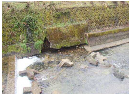
□護岸が崩れかけている
