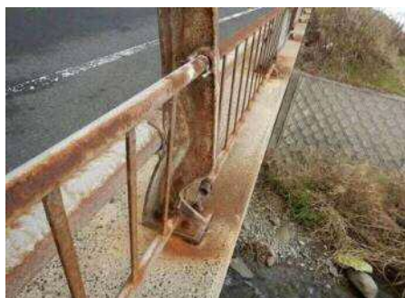
□ 柵が錆びている
