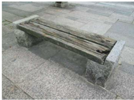
□木製施設が腐っている
