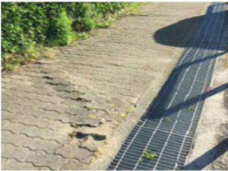
□園路に段差ができている
