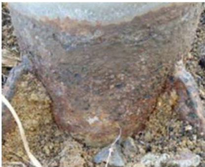
□標識柱の根元が錆びている
