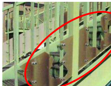
□ 歩道橋のパネルが壊れている
