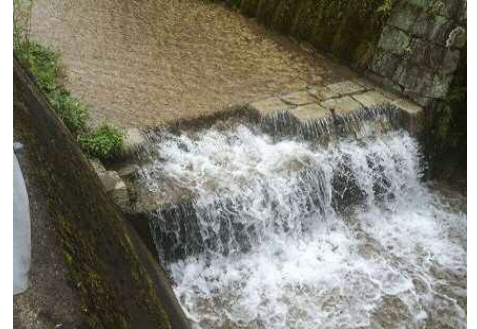
□構造物が一部壊れている
