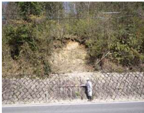
□のり面が崩れている
