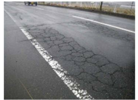
□舗装がひび割れしている
