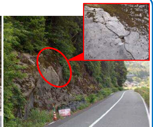
□のり面にひび割れがある
