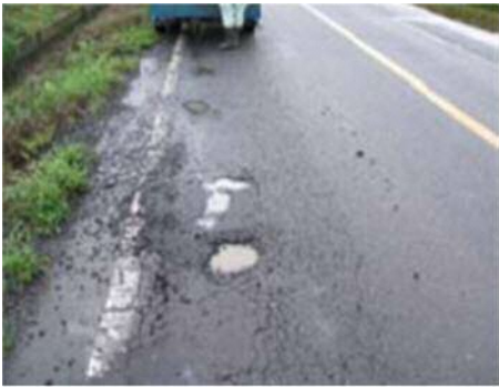
□舗装の一部に穴が開いている
