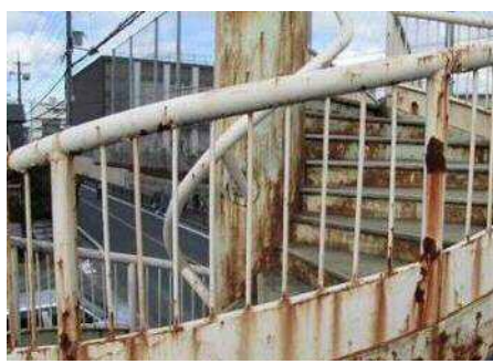
□ 歩道橋が錆びている
