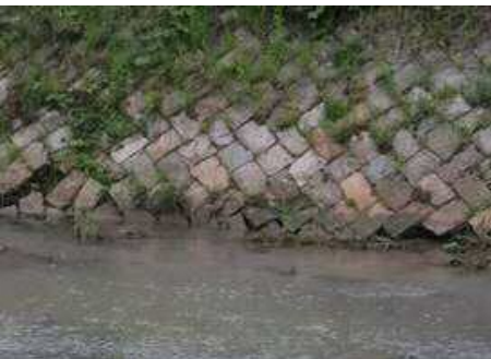
□護岸が崩れかけている
