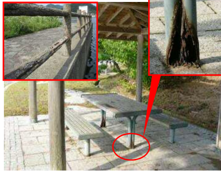
□施設が壊れている
