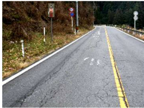
□舗装が波打っている
