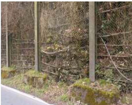
□落石を止める網や柵が壊れている
