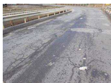
□ 舗装がひび割れしている
