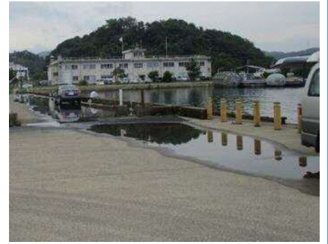
□舗装が沈んでいる
