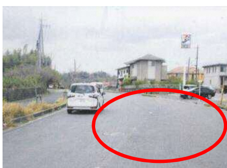
□ 区画線が確認できない
