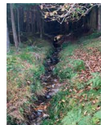
整備が望まれる脆弱な治山ダム下流水路
